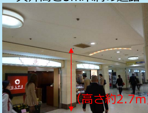
天井高さ3m未満の通路
