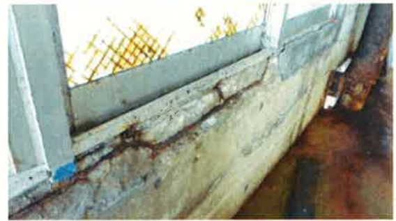
老朽化により危険な状態
