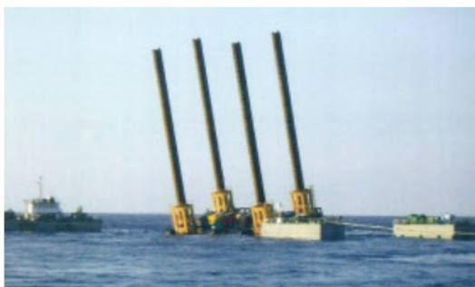
沖ノ鳥島の港湾係留施設建設現場で傾く浮栈橋（30日、関東地方整備局港湾空港部提供）=共同
