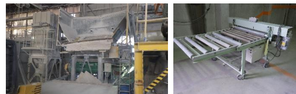
左：廃石膏ボード再生専用の破碎施設 （紙くず、ガラスくず、コンクリートくず及び陶磁器くずの破碎施設） 右：廃畳専用の切断施設（繊維くずの切断施設）など
