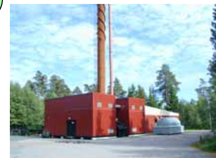
大型ペレットボイラー
