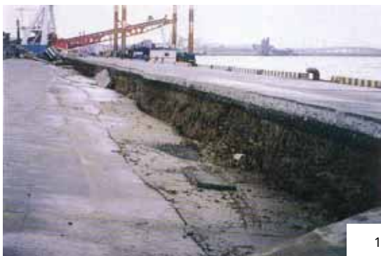
岸壁の被災状況（イメージ写真）
