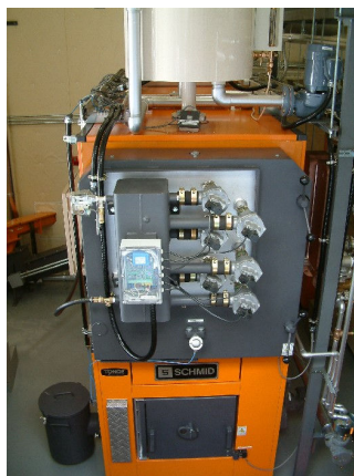
（H16年度導入五味温泉木質バイオマスボイラー）
