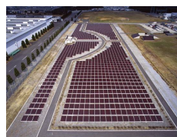
太陽光パネル
