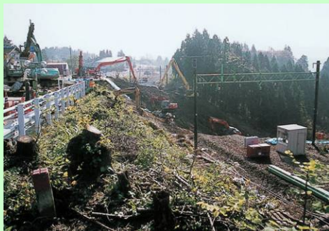
上越線の線路が見えないほどの被害があった小千谷ー川口間
