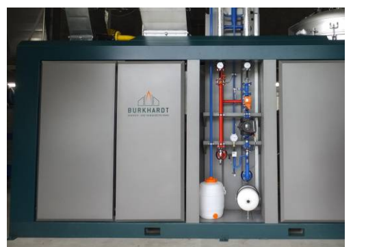
本格稼動する木質ペレットガス化熱電供給装置(小山町)
