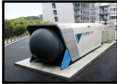
九州大学 燃料電池発電所
