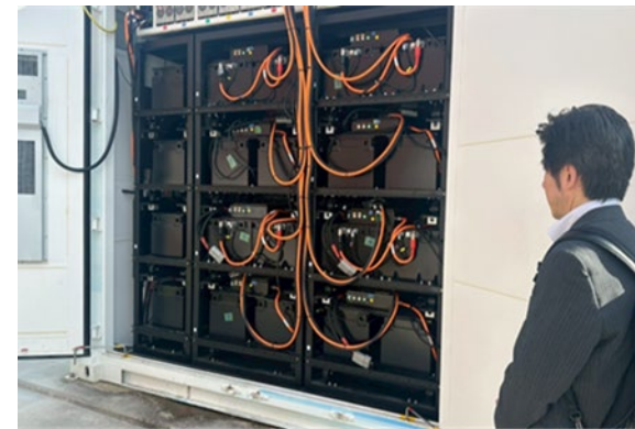
MEGALORE (メガロア) の内部 (地元企業が開発したフォークリフト用リチウムイオン バッテリーを再利用したコンテナ蓄電システム)
