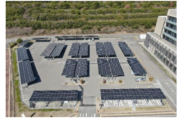
聖隷淡路病院(淡路市夢舞台サステナブルパーク内) ※地産地消エネルギー(太陽光発電)
