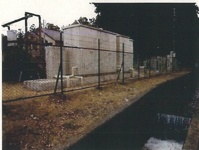
右岸側にある鳥野目浄水場
