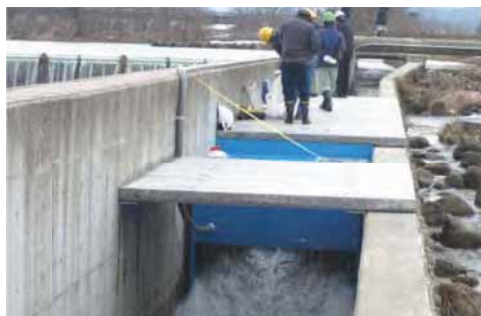
図表③-22 発電システム設置例 1 (秋田県雄物川、定格 8kW)
