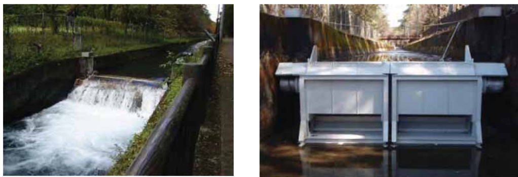
図表③-25 発電システム設置例 1(栃木県内農業用水路、8kW×2基)
