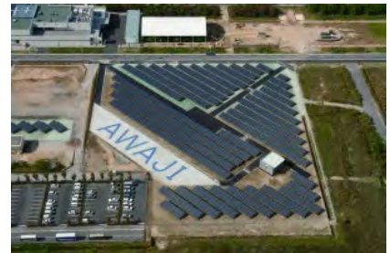
淡路市メガワットソーラー発電施設
