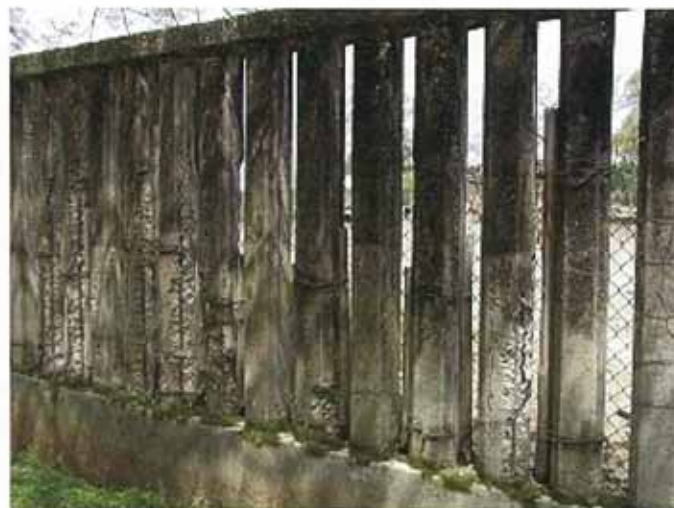
鹿苑の状況（外周柵の老朽化）
