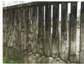
▲老朽化の進む外周柵
