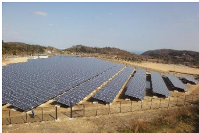
住民参加型の太陽光発電所 (くにうみ太陽光発電所)
