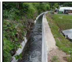
老朽化した用水路の整備・更新
