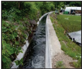
老朽化した用水路の整備・更新
