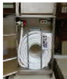
(易操作性1号消火栓)
