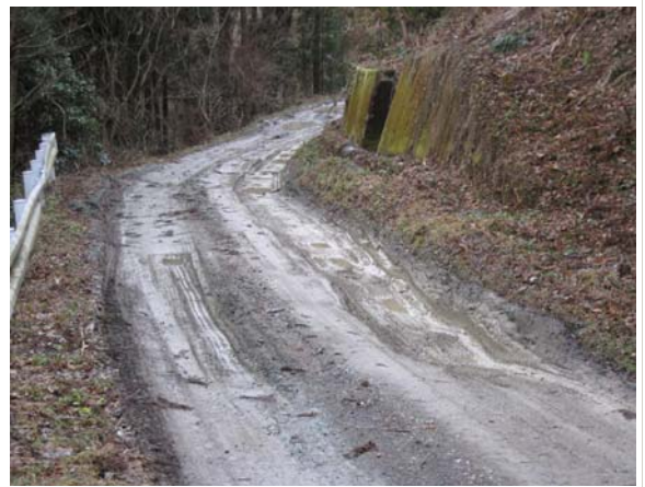
林道下名大田口線の路面状況
