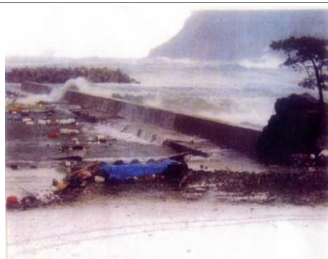
野波漁港（防波堤越波による被害）
