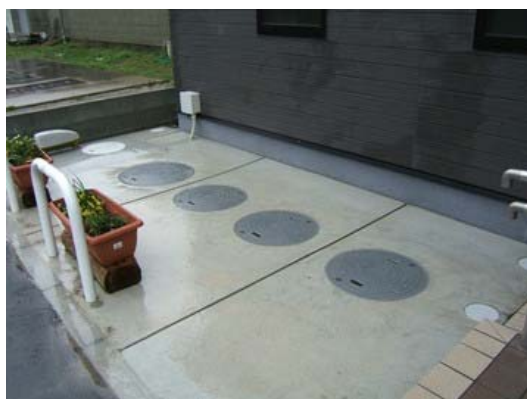
合併処理浄化槽
