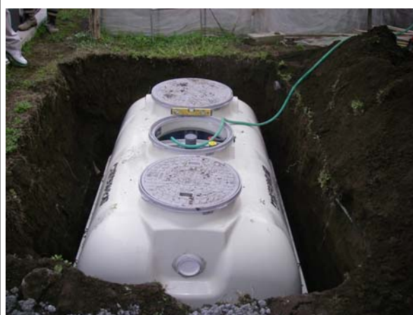
浄化槽の整備
