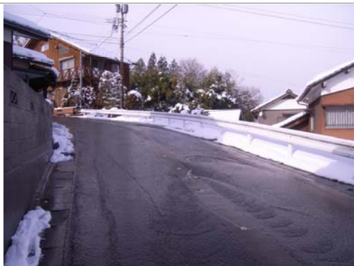
豊富な水資源を活用した消雪装置の設置
