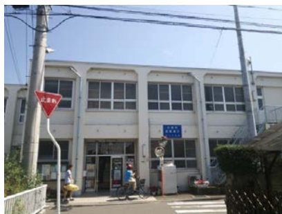
必要な耐震性能を有さず、狭隘で駐車場のない「現在の余土公民館」
