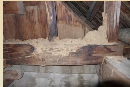
シロアリ被害の様子
