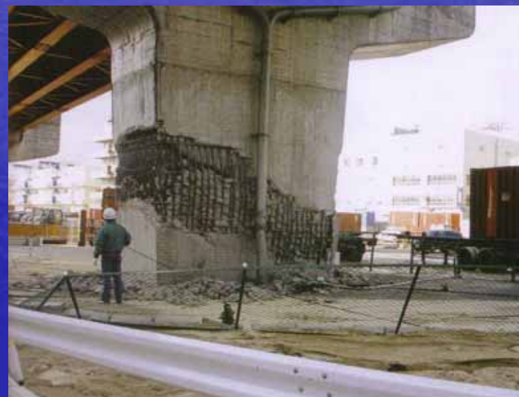
橋脚の座屈状況
