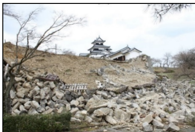
崩落した石垣 (平成23年)
