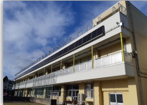
市内小学校の太陽光発電設備
