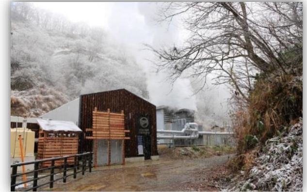
松之山温泉地熱バイナリー発電所
