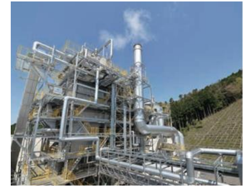
木質バイオマス発電所
