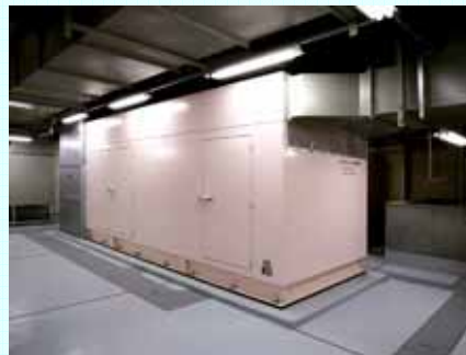
非常用発電設備
