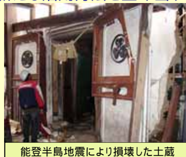
能登半島地震により損壊した土蔵
