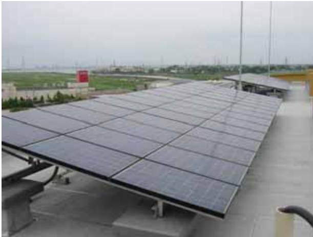
市営住宅セントラルコート太陽光発電設備 H15.8 設置 公共施設はこの他多数設置
