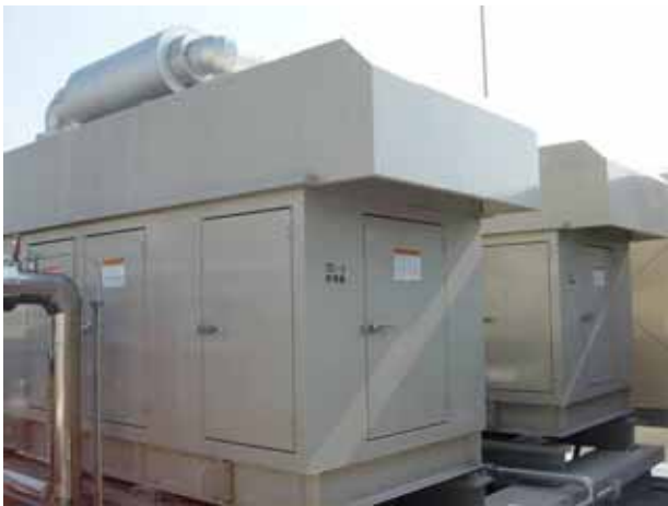
市内商業施設のガスコージェネレーション H16.7 設置
