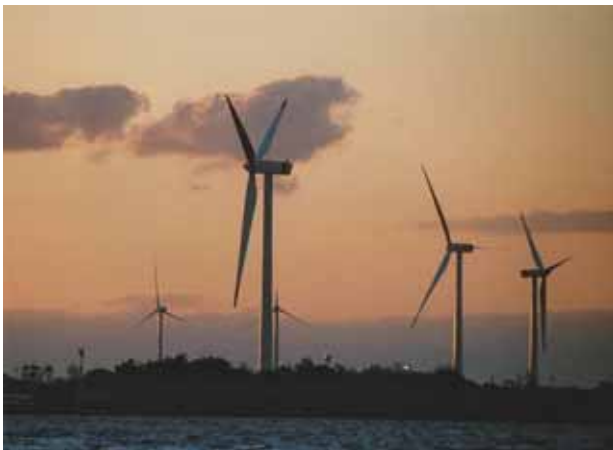
風力発電設備
