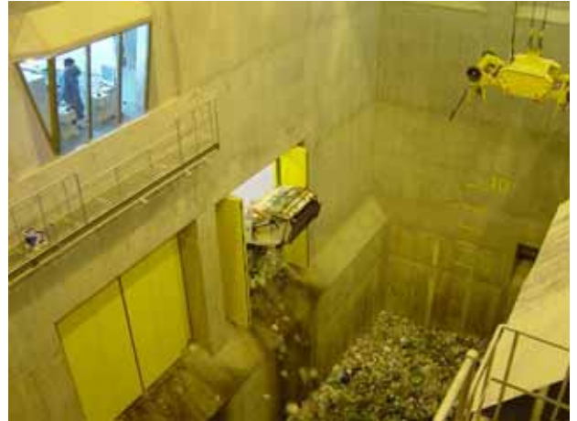
炭生館のゴミピット。田原市及び渥美町の一般廃棄物をPFI方式で処理。
