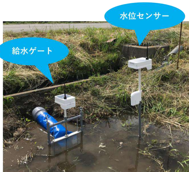
水位センサーと給水ゲート
