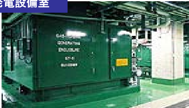
非常用発電設備室
